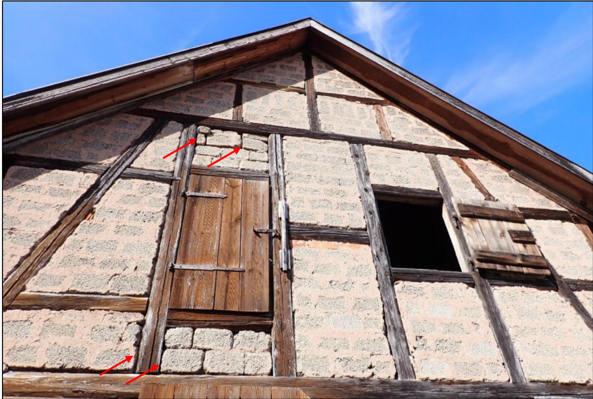
Abbildung 15: Spalten im Mauerwerk (rote Pfeile) an der Scheune C, Hirsauer Straße 23.
