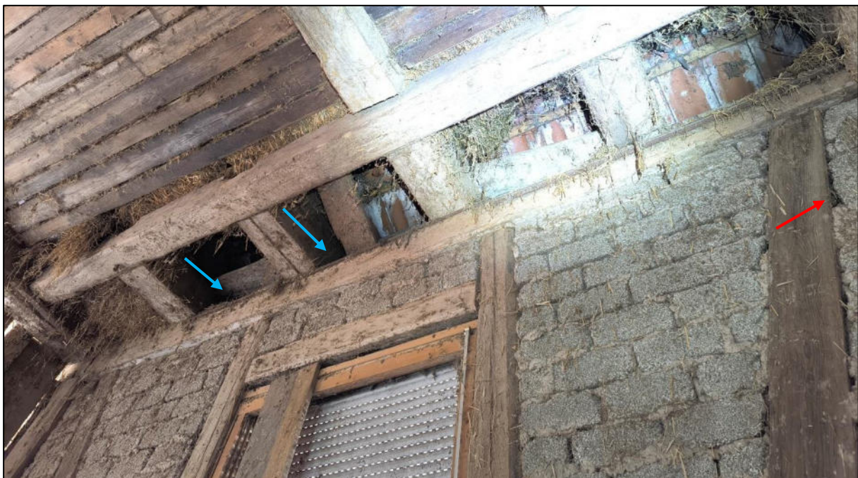
Abbildung 12: Spalten im Mauerwerk (roter Pfeil) sowie Nischen auf Querbalken (blaue Pfeile) in der Scheune der Hirsauer Straße 21.
