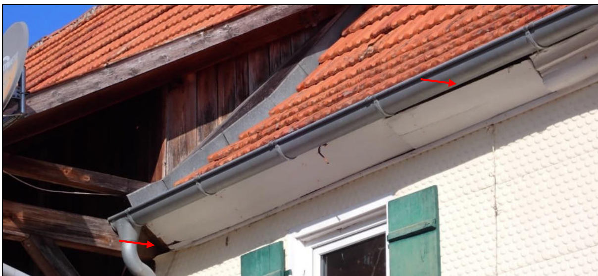
Abbildung 8: Schadstellen am Traufkasten (rote Pfeile).
